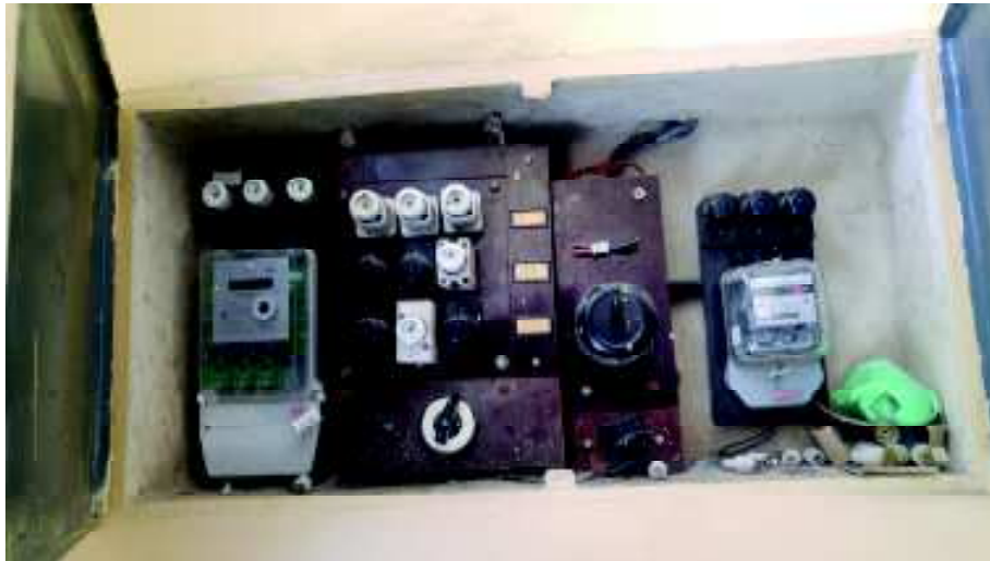
FOT. 5 ISTNIJĄCA INSTALACJA ELEKTRYCZNA
