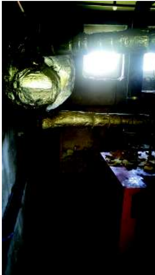
FOT. 7 ISTNIĄCA INSTALACJA C.O.
