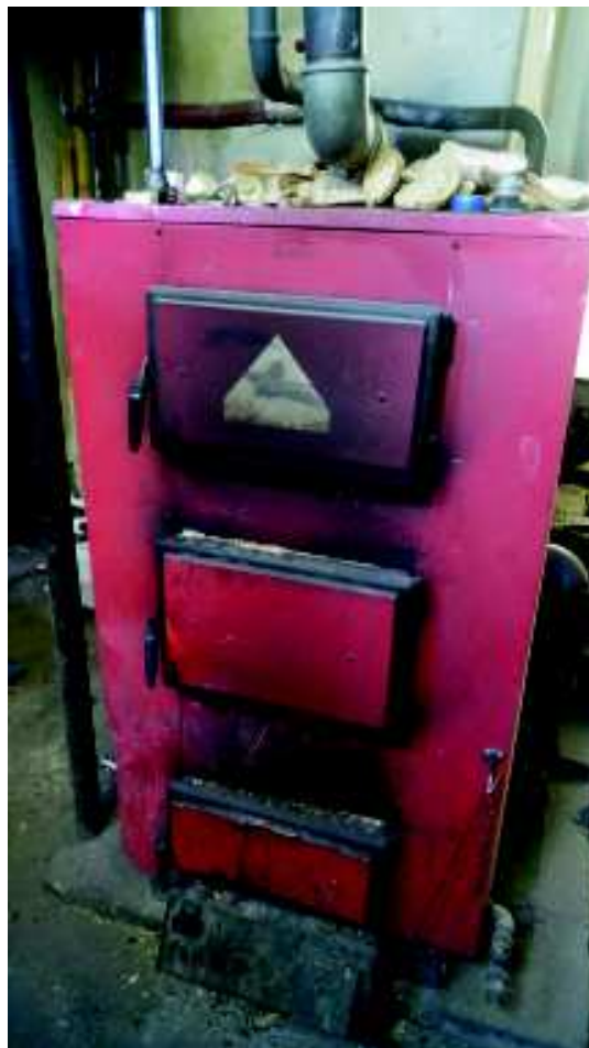
FOT. 6 ISTNIJĄCA INSTALACJA C.O.
