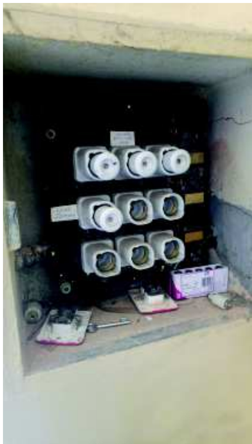
FOT. 4 ISTNIĄCA INSTALACJA ELEKTRYCZNA
