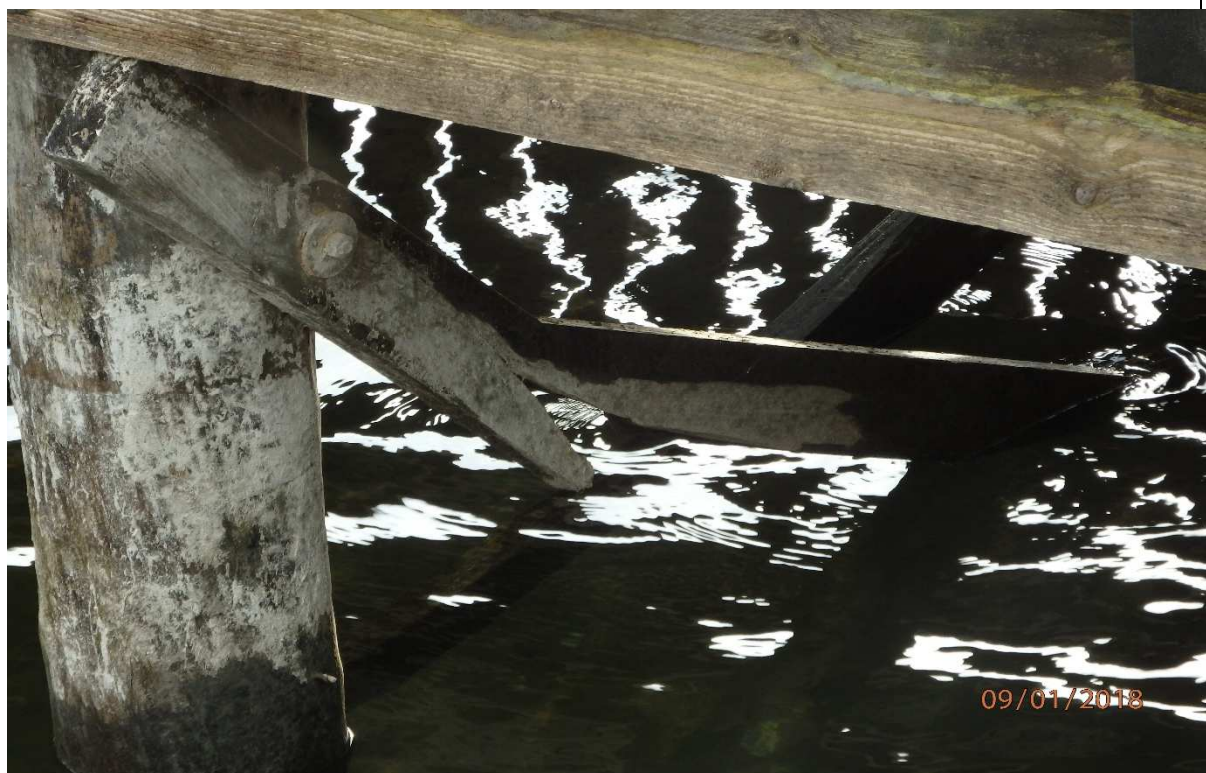
Zdjęcie nr 21niszczone stężenia poprzeczne pali.
