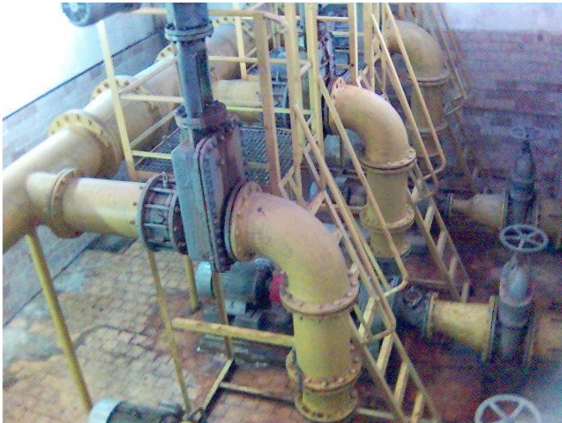
d) pompownia ścieków - galeria zasuw
