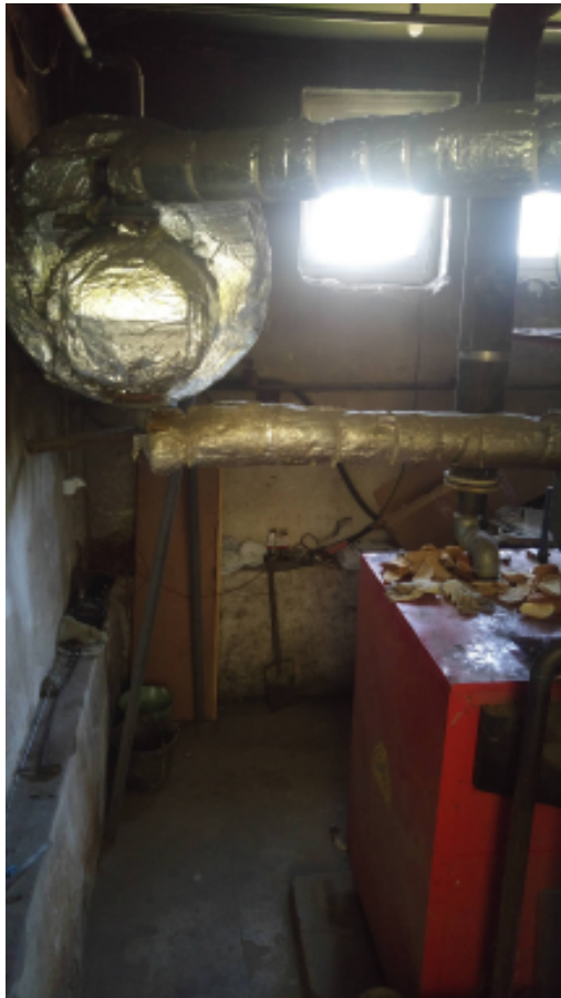
FOT. 7 ISTNIJĄCA INSTALACJA C.O.
