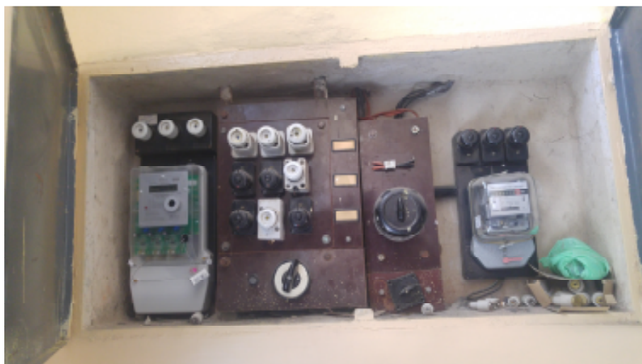
FOT. 5 ISTNIJĄCA INSTALACJA ELEKTRYCZNA
