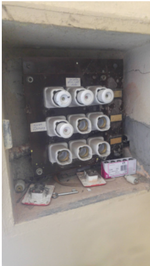
FOT. 4 ISTNIĄCA INSTALACJA ELEKTRYCZNA
