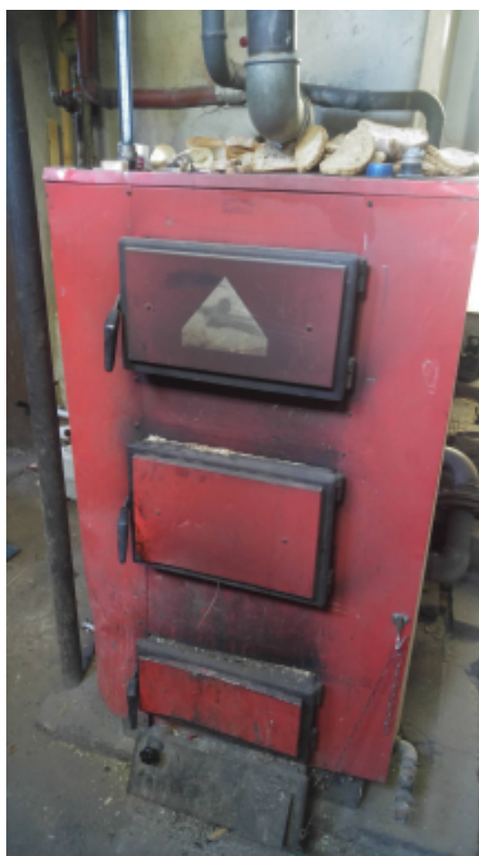
FOT. 6 ISTNIJĄCA INSTALACJA C.O.
