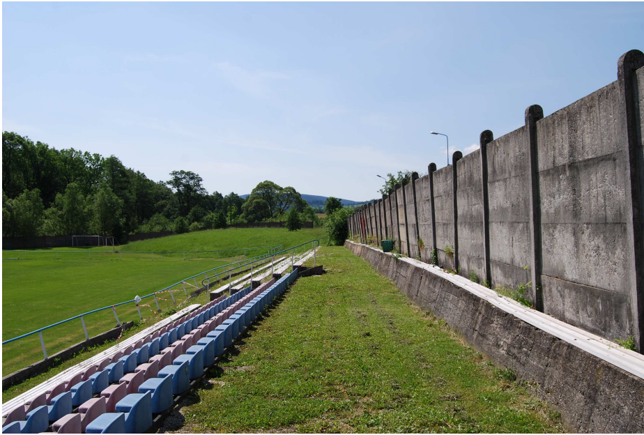
Widoczne pochylenie istniejącego ogrodzenia, mur oporowy poniżej ogrodzenia wykorzystywany jako dodatkowy rząd siedzeń.
