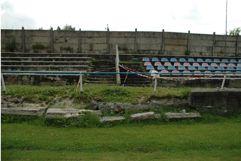
Zawalony mur oporowy pomiędzy trybunami a boiskiem w środkowej części trybun.
