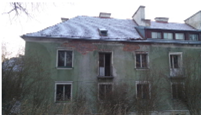
elewacja tylna - uszkodzone tynki w wyniku przecieków z dachu
